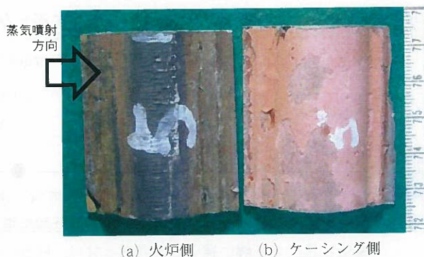
写真1 ボイラ蒸発管の損傷箇所の抜管材外観
